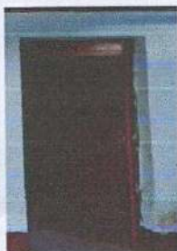
Foto 3: sustitucion de puerta por picadura de lamina y oxido
